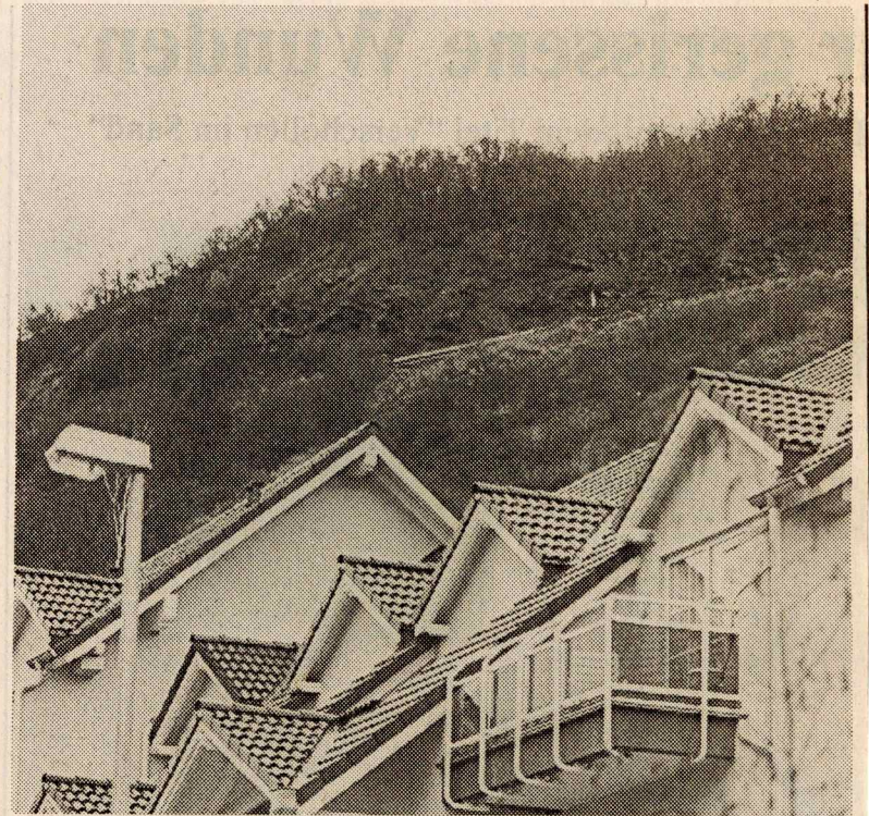
Risse und Bodenbewegungen: der Rothenberg ist zu einer Bedrohung geworden. Bild: Uwe Feuerbach
